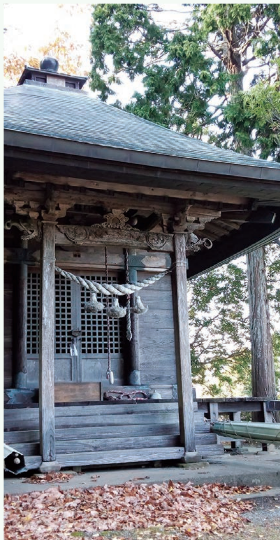
津波は観音堂に続く急坂を駆け上がった
